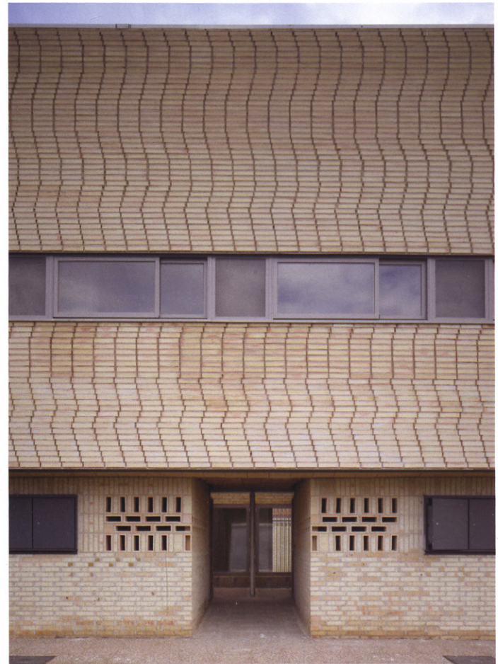
En la parte superior de la fachada las juntas de los ladrillos vibran generando ondas. In the upper part of the façade, the brick bonds shake generating waves.
